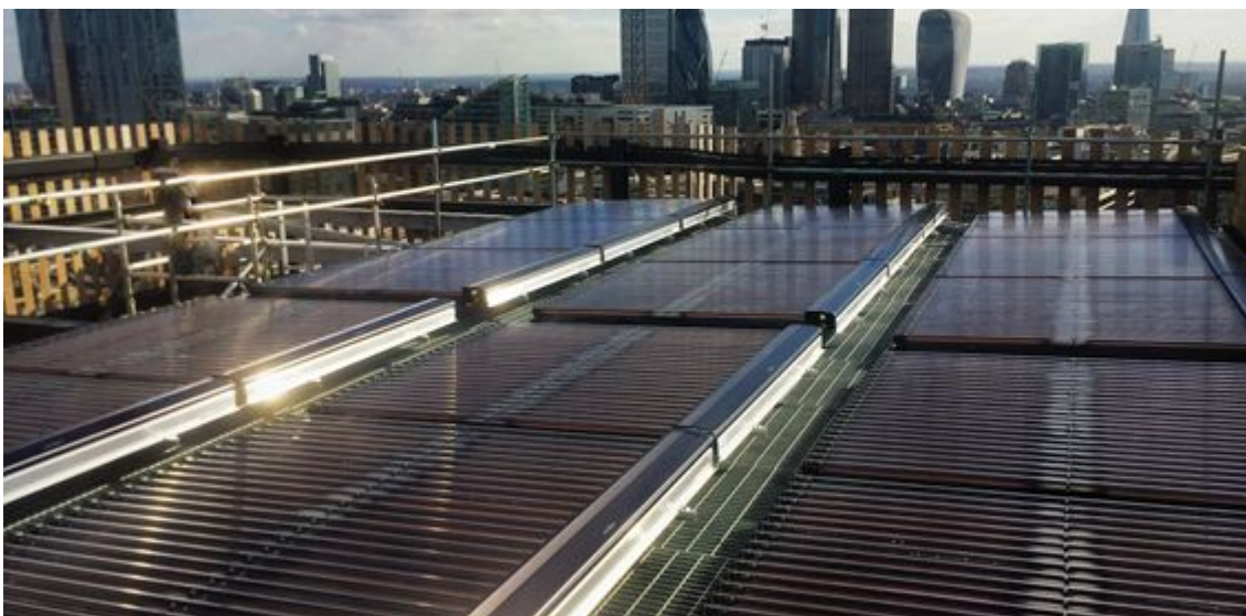
Imagem 6 - Sistema de aquecimento solar predial, em Londres. Disponível em http://www.solaruk.net/solarimages/gallery/Old%20Yard%202.jpg
