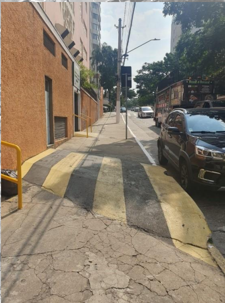
Calçadas irregulares e falta de acessibilidade
